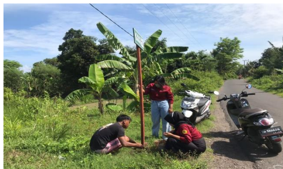
Figure 3. Pemasangan plang jalur evakuasi & titik kumpul
