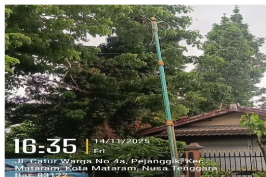
Gambar 3. Kondisi PJU di Jalan Catur Warga
