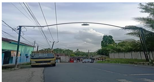
Gambar 2. Kondisi PJU di Jalan Peternakan
