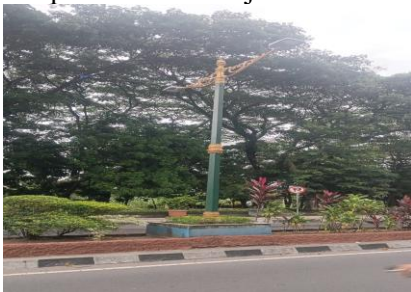
Gambar 1. Kondisi Lampu LED jalan Udayana
