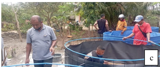
Gambar 3. (a) Pengadaan bahan material pembuatan alas kolam, (b) Kegiatan pembuatan alas kolam berupa beton, (c) Perakitan dan pemasangan kolam wermesh.
