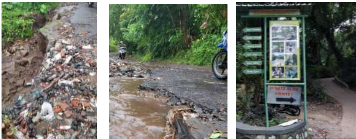
Gambar 2. Kondisi salah satu jalan di Desa Sesaot yang memerlukan penanganan
