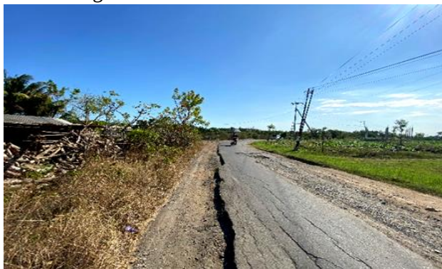
Gambar 1 Kondisi jalan yang rusak di tepi Pantai Jerowaru
